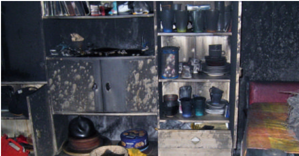
Rußverschmutzung und Brandschäden nach einem Feuer in der Gartenlaube.
