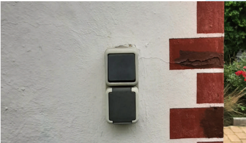
Sichtbare Stromanschlüsse an der Außenwand sollten abgeschaltet werden.
