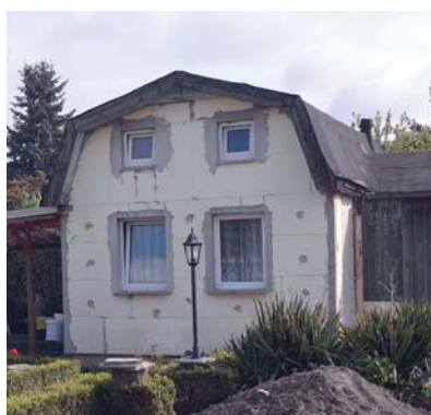
Grundsanierung mit Wärmedämmung? Da ist der Bestandsschutz weg. Foto: SLK
